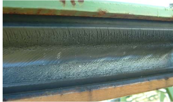
Thermische Zerstörung bereits deutlich sichtbar
